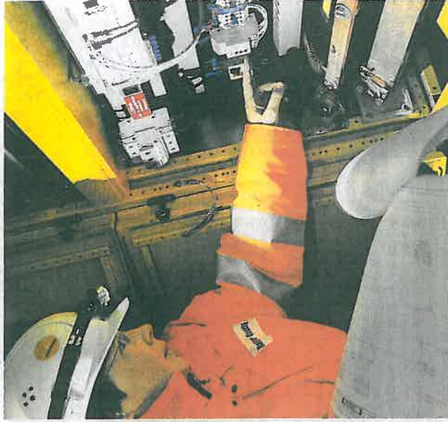
Steuernische einer 50Hz-Schaltanlage.
