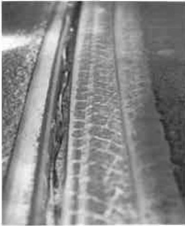
Bild 23: Die Auswirkungen des zu großen Anfahrwinkels werden in Form von Spänen aus der „Fräswirkung“ des Spurkranzes deutlich sichtbar
