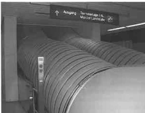
Bild 17: Der Platzbedarf der großvolumigen Zu- und Abluftanlagen erfordert eine genaue Planung und Vorbereitung
