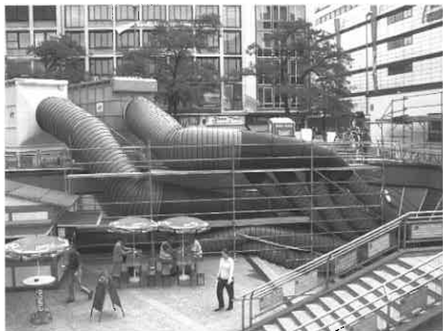
Bild 19: Temporäre Belüftungsanlage in der City
