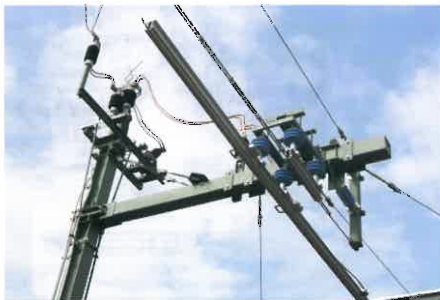
Bild 16: Übergang vom Kettenwerk zur Deckenstromschiene vor einer Werkshalle
